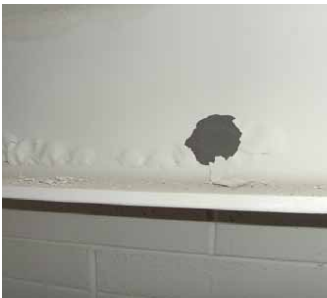
KÁROSODOTT FELÜLET – TAPADÁSVESZTÉS, MEGSZŰNIK AZ ELŐÍRT VÉDELEM
