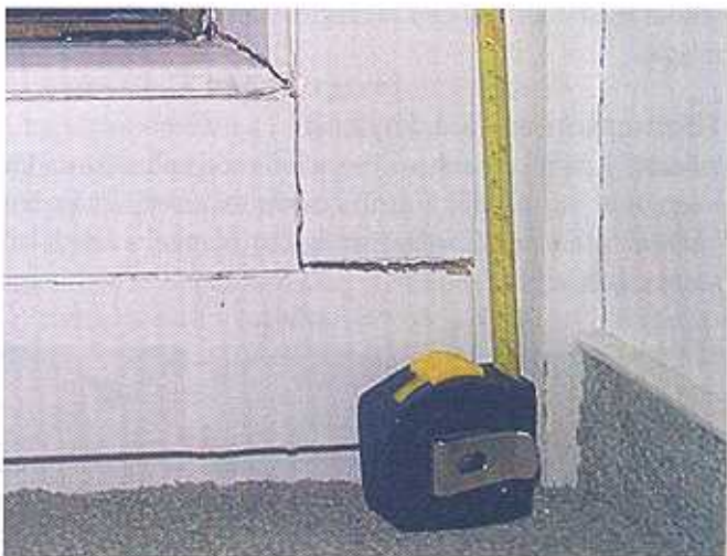
3. kép: Párássá, megdagadás miatt szétnyílt csapozású erkélyajtó alsó sarok
