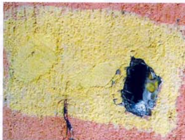
Homlokzati panel sérülés
