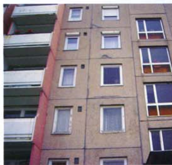
Homlokzati elem repedései
